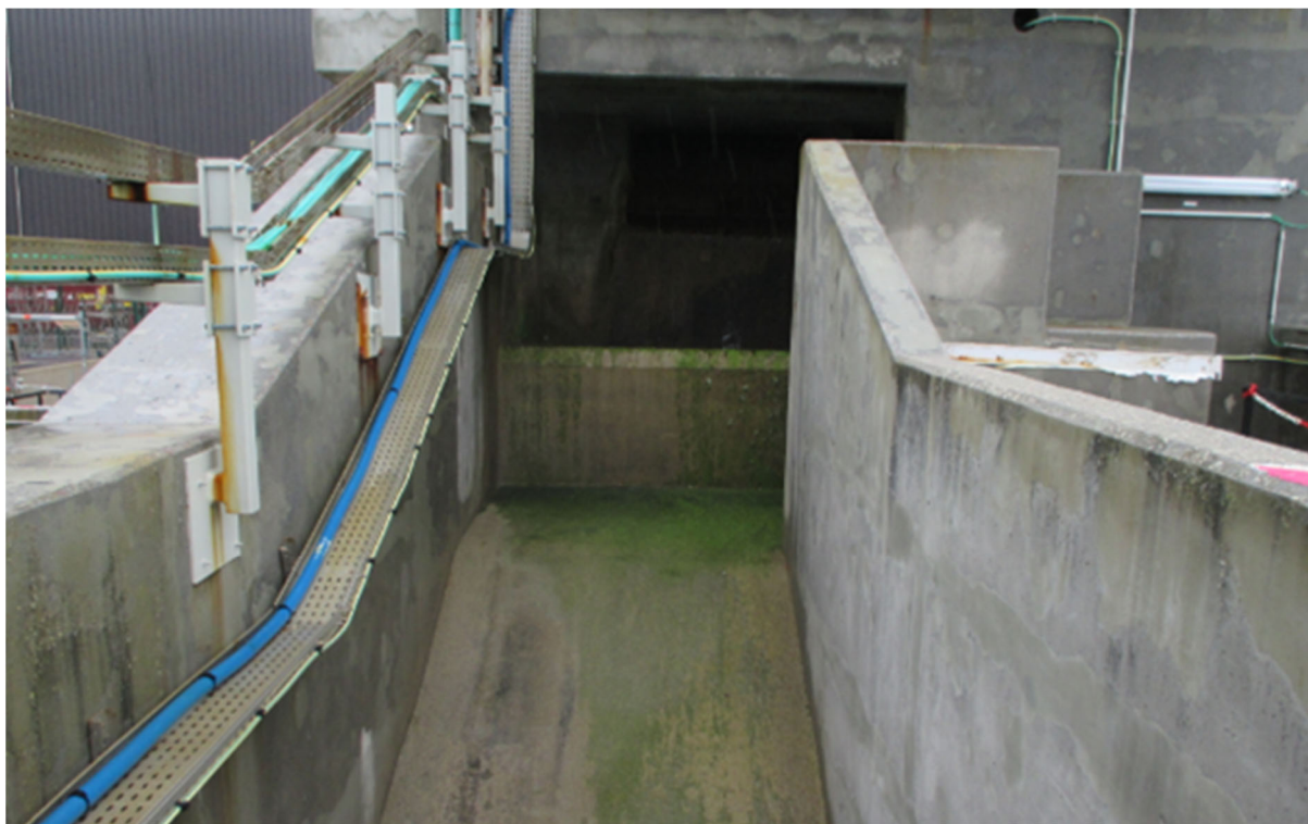
Figure j : Localisation du débordement du toboggan de diversification SEC / SRU
