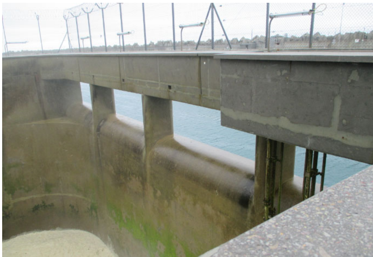
Figure I : Trop-plein du bassin de rejet CRF
