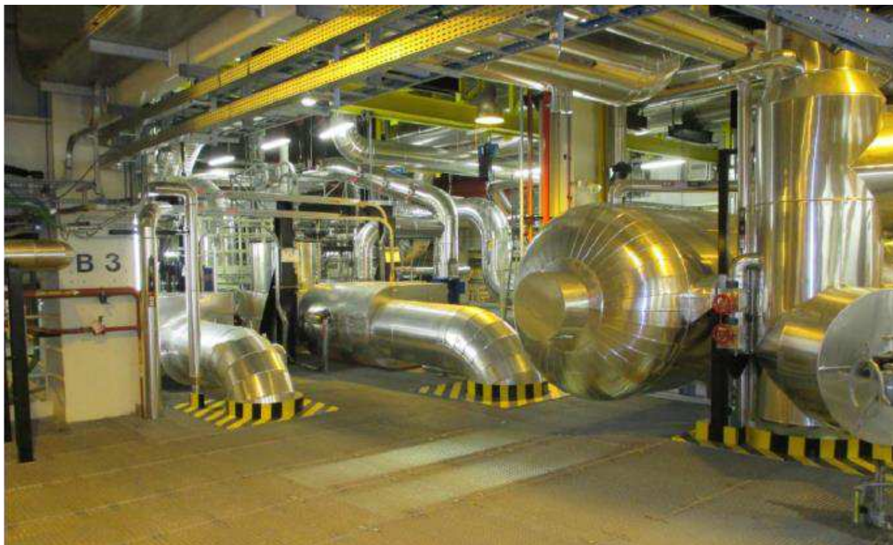
Figure 2.f : Salle des machines du réacteur EPR
