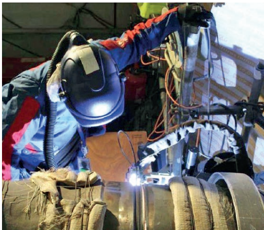
Mise en œuvre du procédé TIG orbital – soudure sur le circuit secondaire principal
